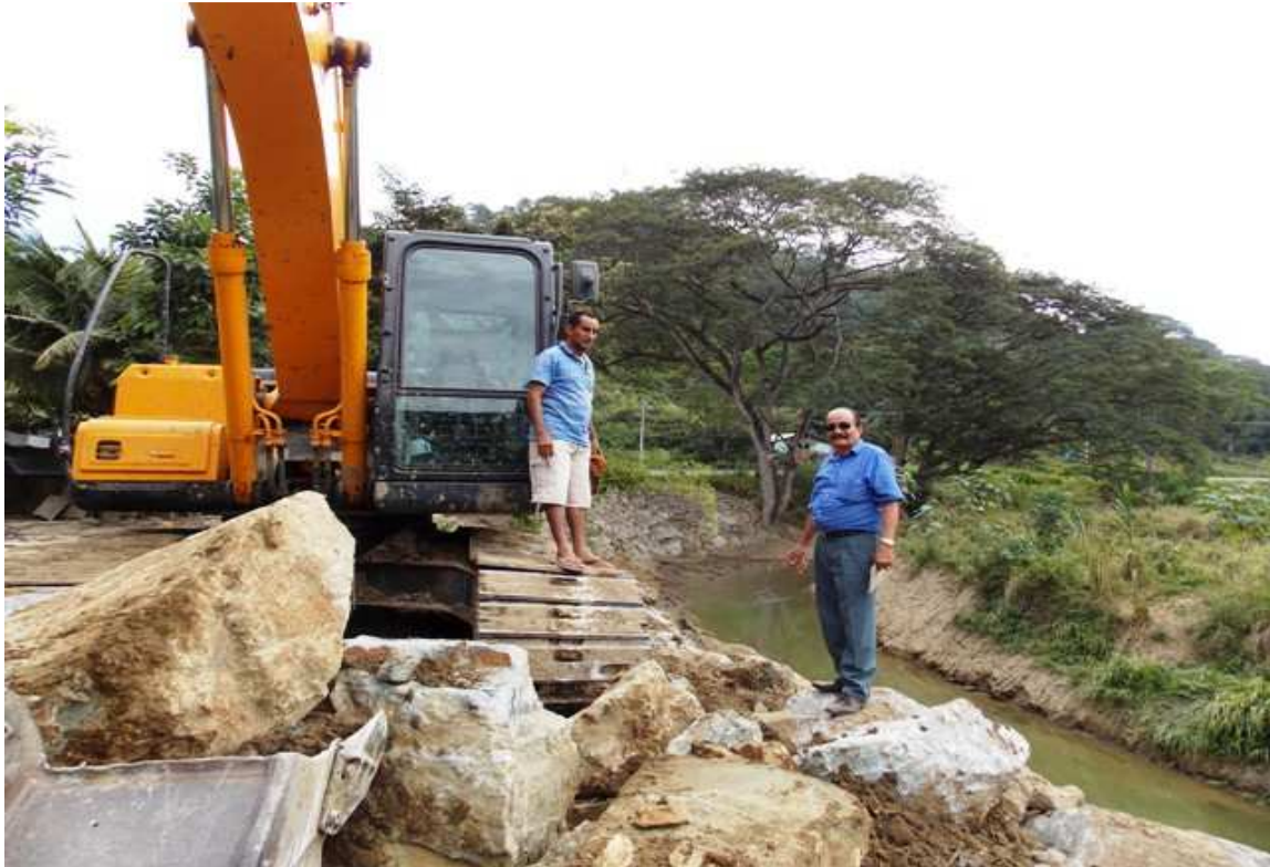
Construcción de protección de la planta de potabilización de agua en el Cerro La Turena.
